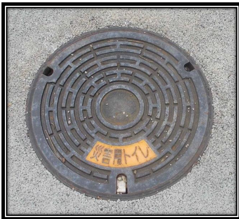
マンホールトイレ
